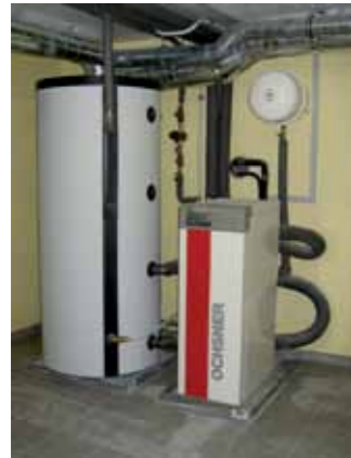
Wärmepumpe mit Warmwasserboiler
